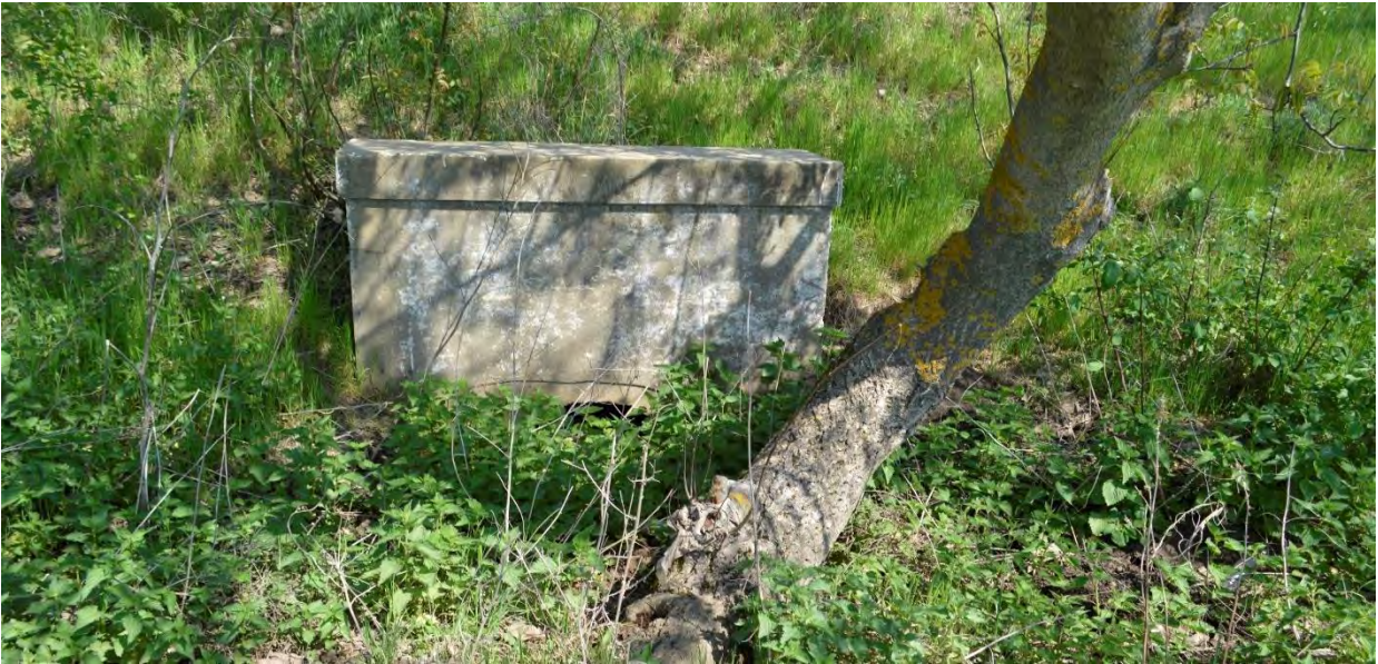
Km 30,280. Vedere în amonte înnămolire 100%
