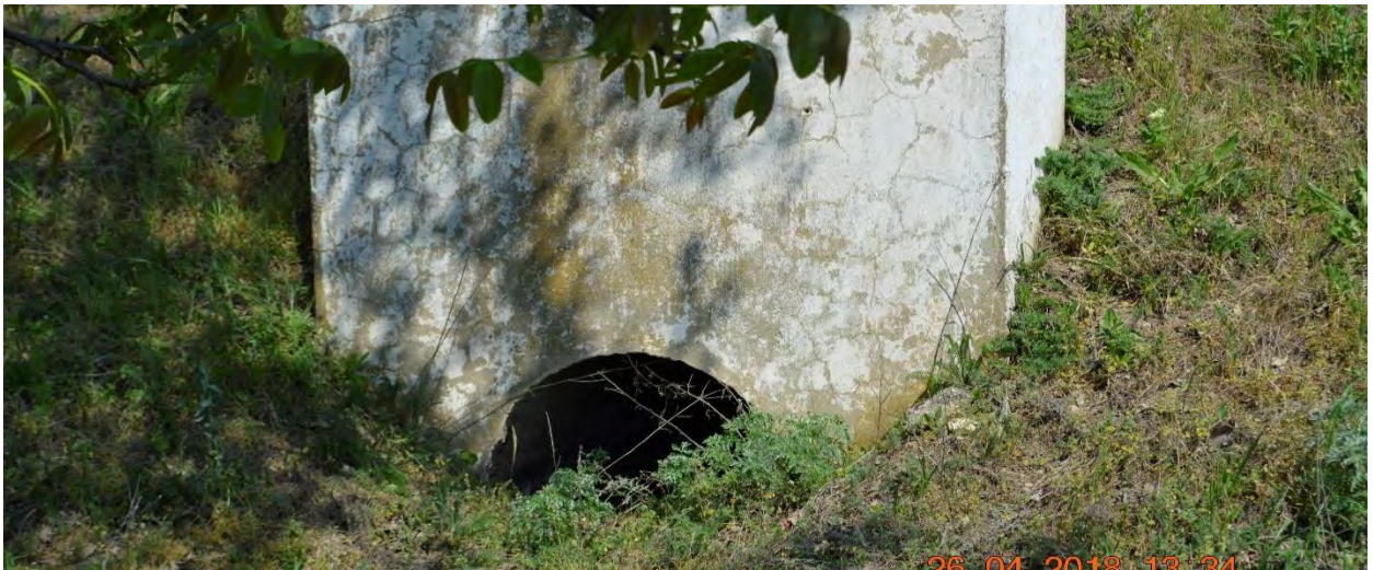
Km 31,880. Vedere în amonte, înnămolire 50%.
