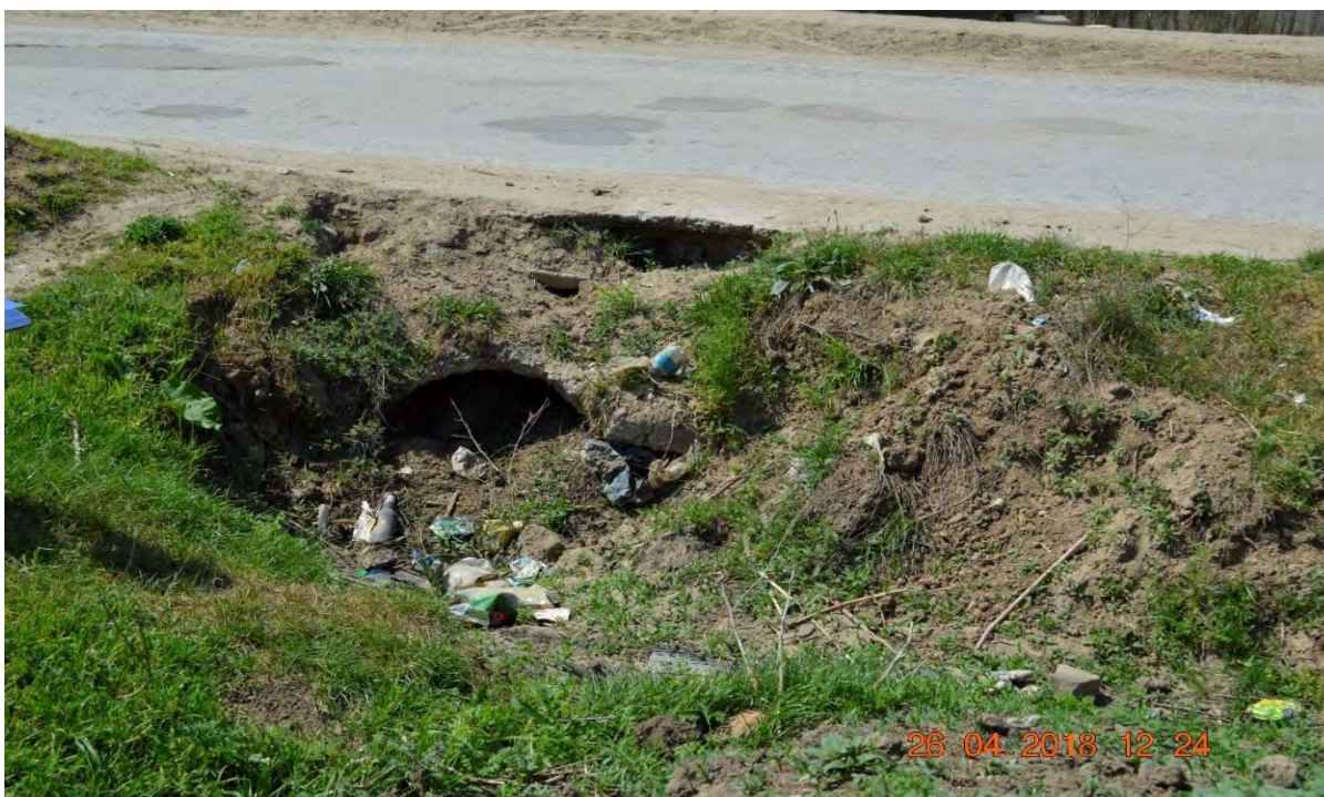
Figura 3.9.2 Podeț înămolit la km 13,400.
