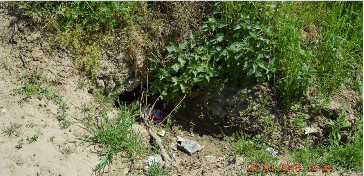
Km 13,600. Intrarea în podeț înnămolită. Sânt necesare lucrări de reparație.
