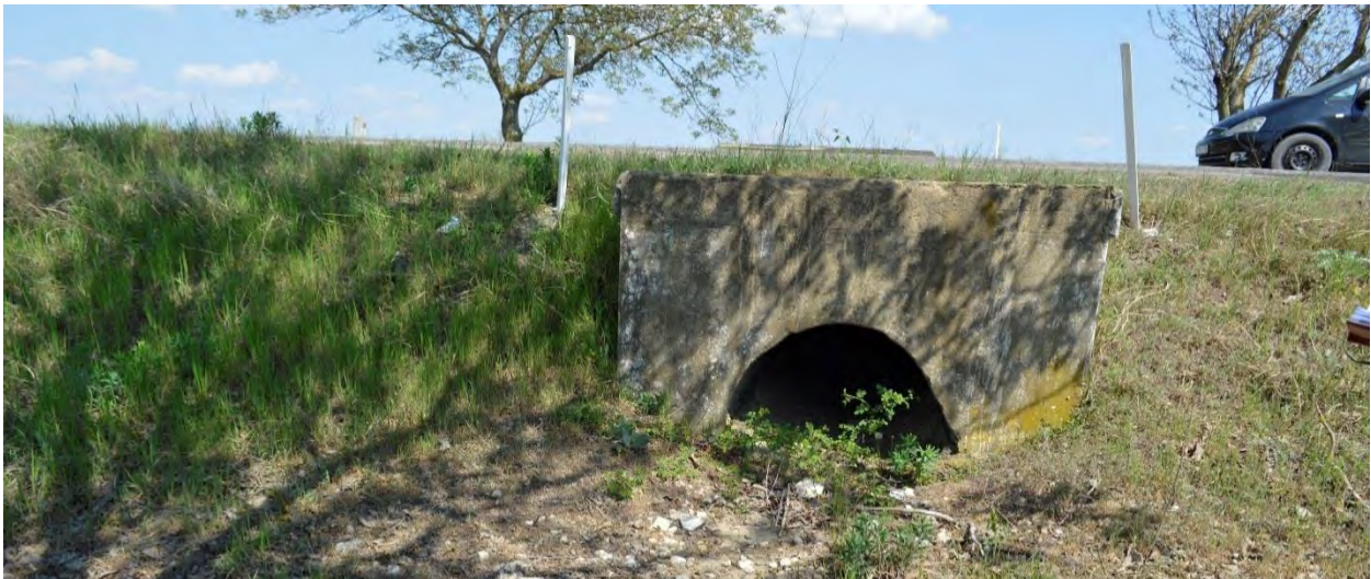
Km 29.480. Vedere în amonte, înnămolire 50%.
