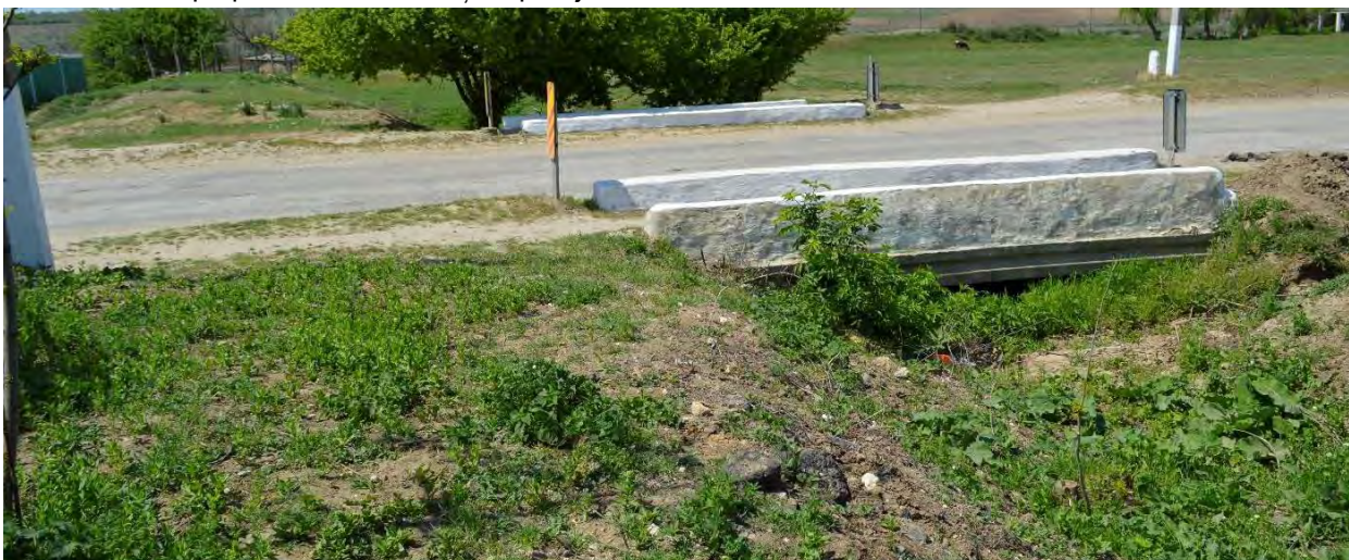
Figura 5.1.2 Înnămolirea podețului la km 6,80
