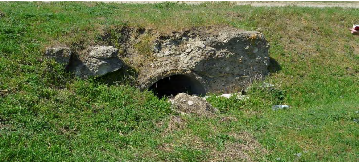
Km 16,200. Vedere în amonte, înnămolire 50%. Sunt necesare lucrări de reparație
