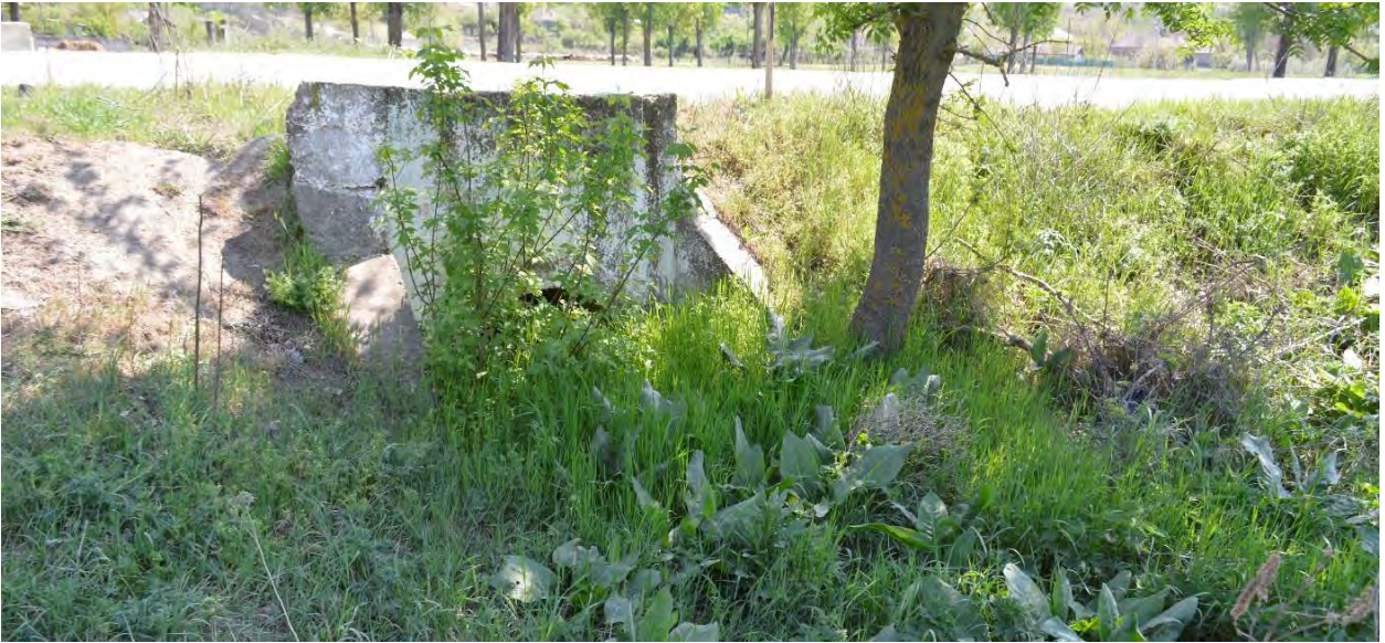
Km 8,600. Ieșirea din podeț necesită lucrări de curățire.
