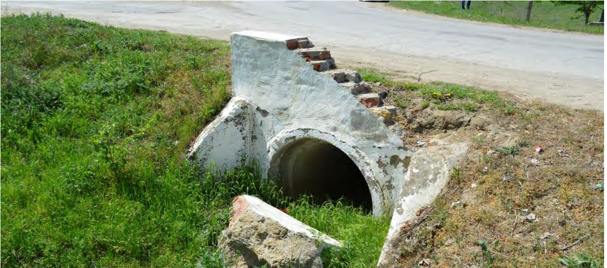
Km 8,600. Portalul la intrarea în podeț necesită reparați.
