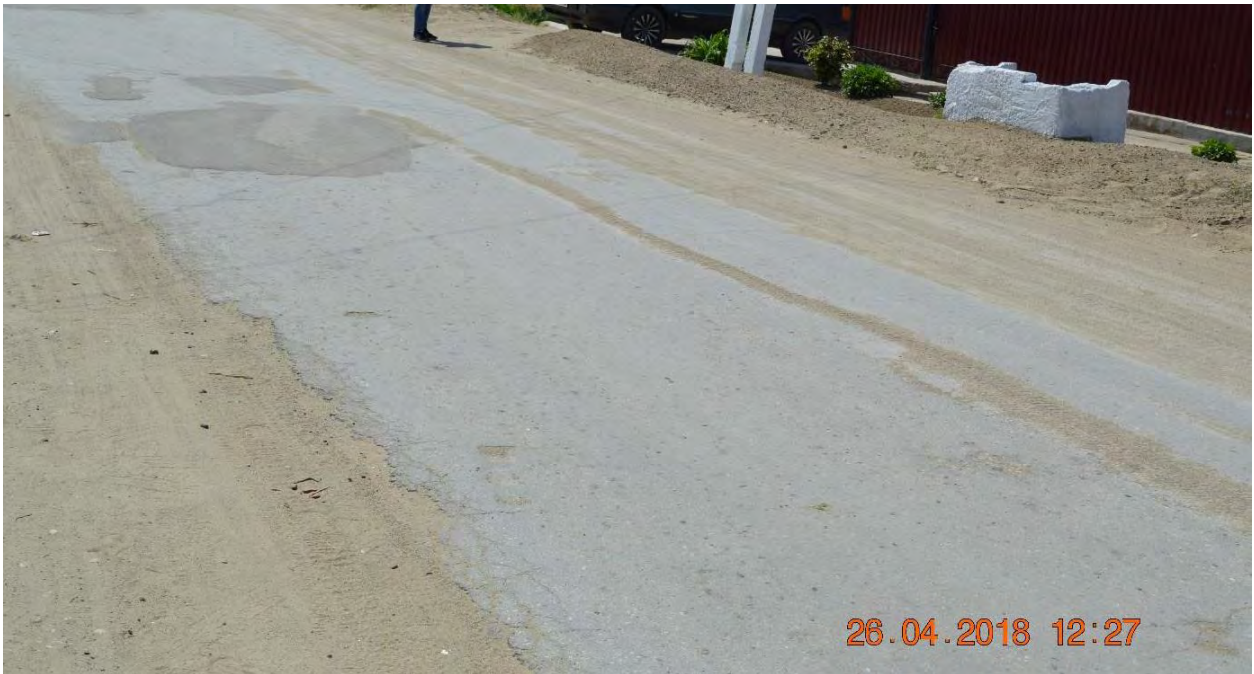
Km 14,700. Partea carosabilă în stare mediocră. Valurile de pământ în lungul părții carosabile, fapt ce înrăutățește condițiile de evacuare a apelor pluviale.
