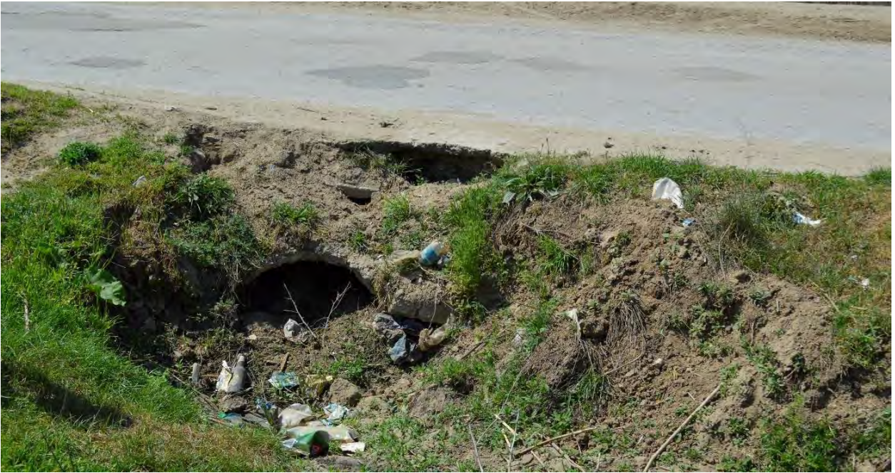
Km 13,600 Podeț defectat, înnămolire 60%.
