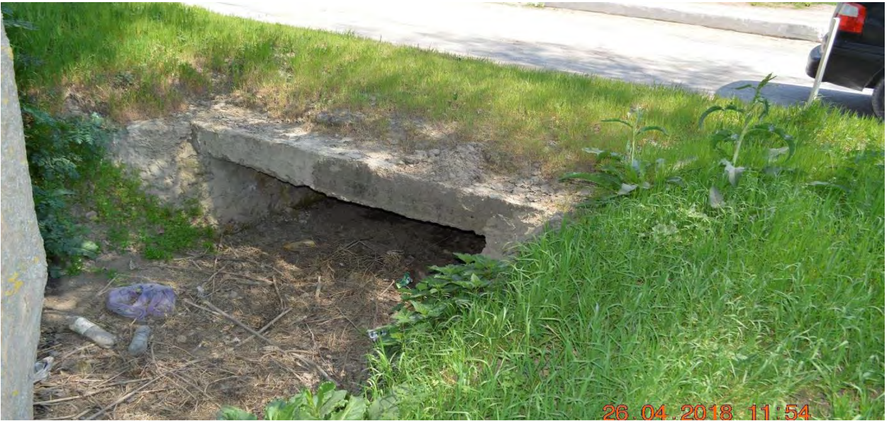
Km 8,00. ieșirea din podeț înămolită 90%.
