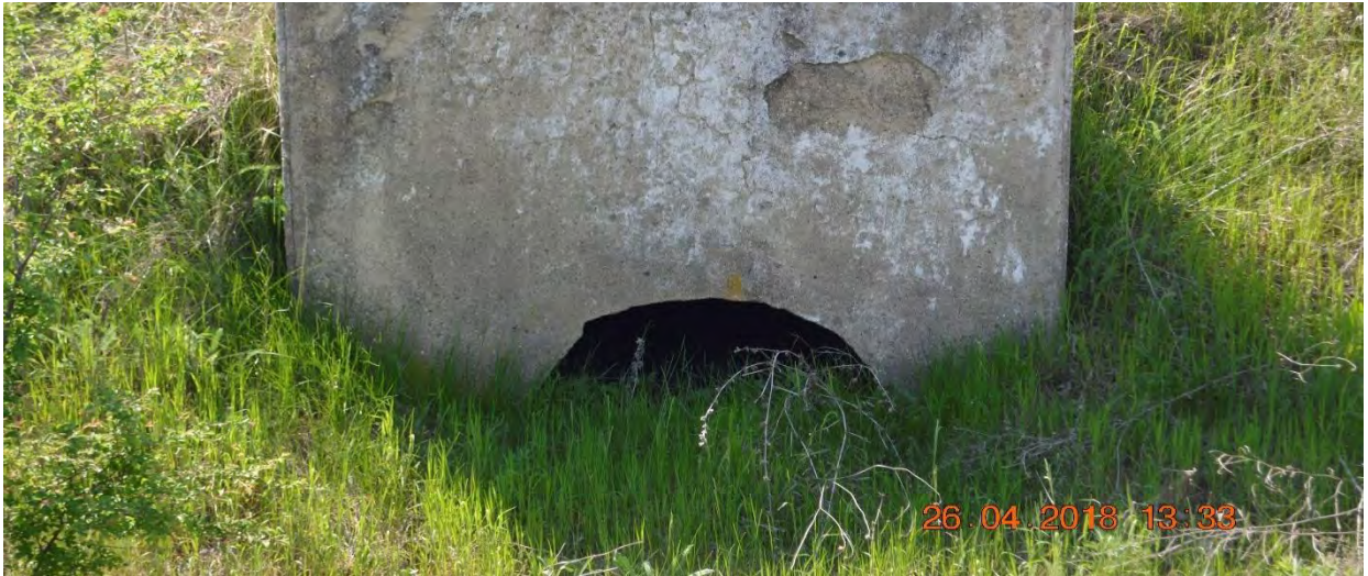
Km 31,880. Vedere în aval, înnămolire 70%.
