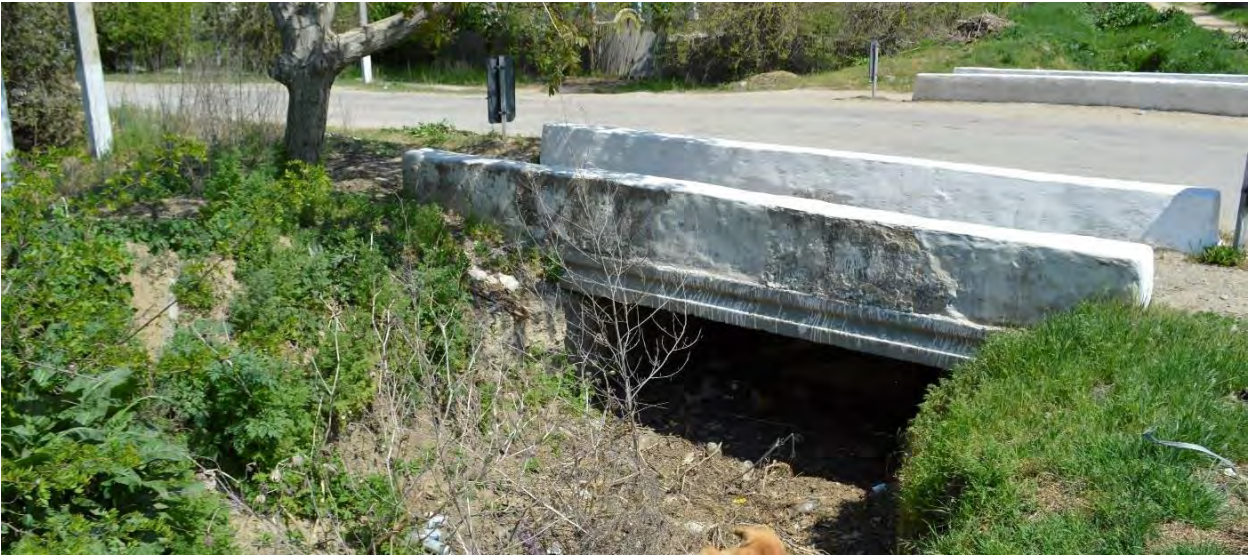
Km 7,400 leșire din podeț, înnămolire 80%.
