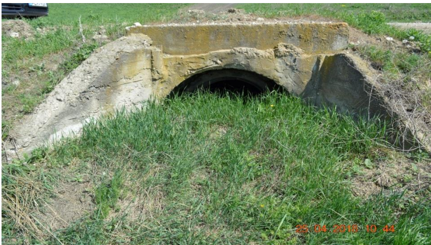
Figura 3.9.2 Podeț înămolit, care afectează teritoriul adiacent în timpul ploilor torențiale
