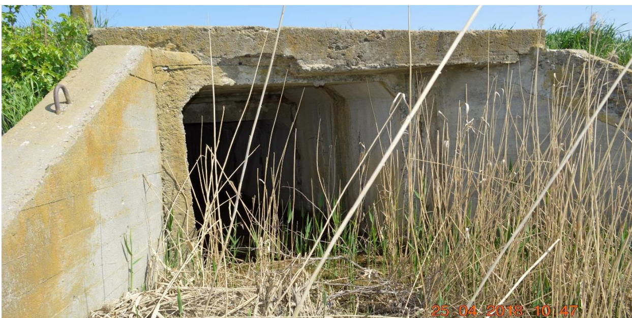
Km 10,290. Intrarea și ieșirea din podețul dreptunghiular necesită reparație Входной и выходной оголовки прямоугольной ж/б трубы требуют ремонта
