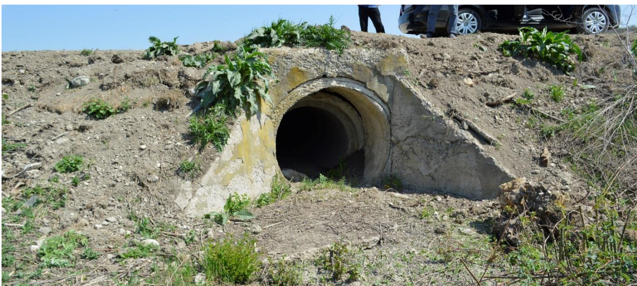
Km 11,200 Podeț tubular. Capurile de intrare și ieșire necesită reparație.
