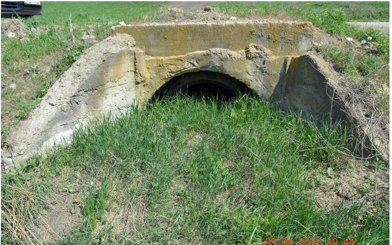
Km 9,300 Vedere în amonte. Sunt necesare lucrări de reparație și curățire.
