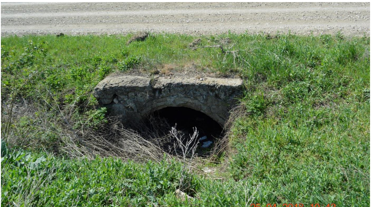
Km 9,300 Vedere în aval. Sunt necesare lucrări de reparație și curățire.
