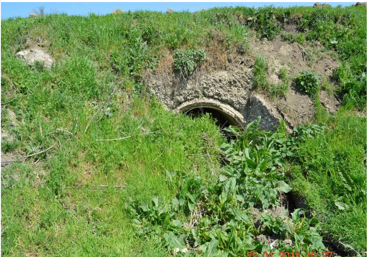
Km 7,100. Vedere în amonte. Înnămolire 90%
