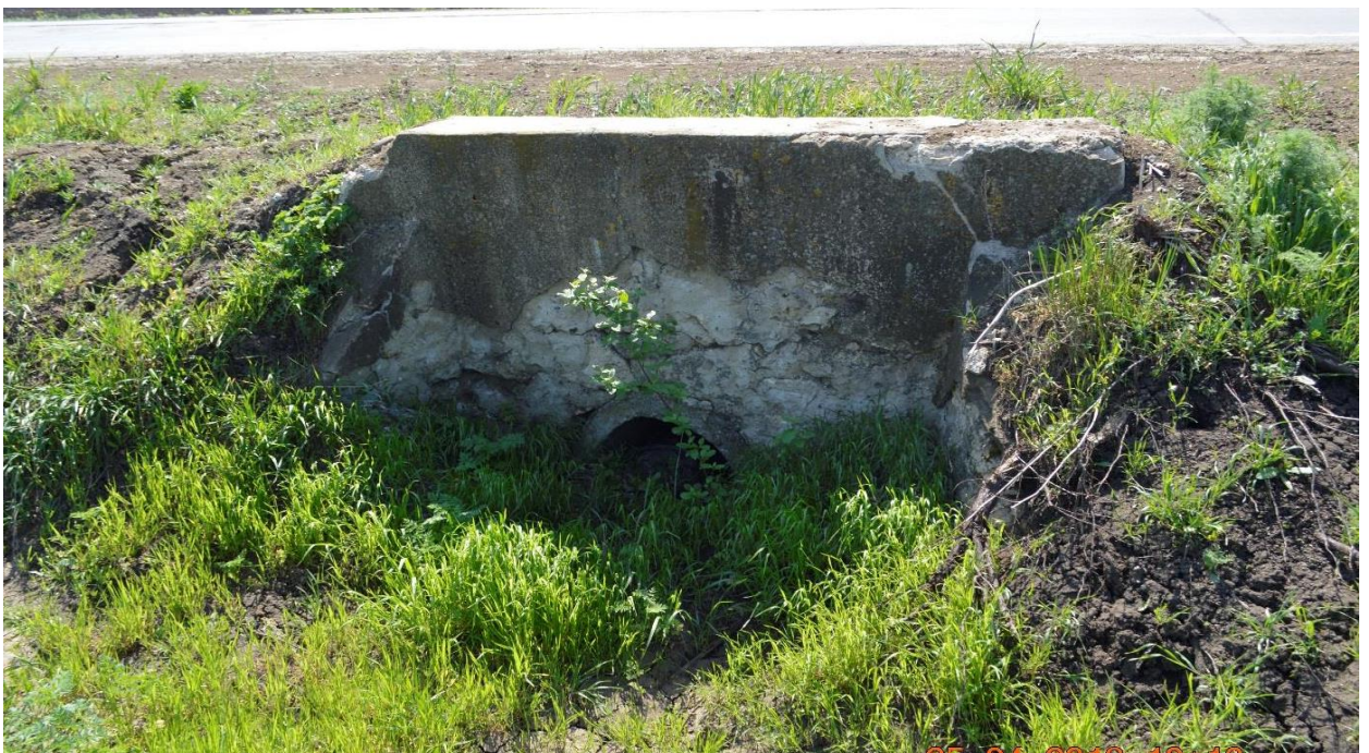
Km 3,200. Vedere în amonte. Înnămolire 50%. Sunt necesare lucrări de reparație și curățire.
