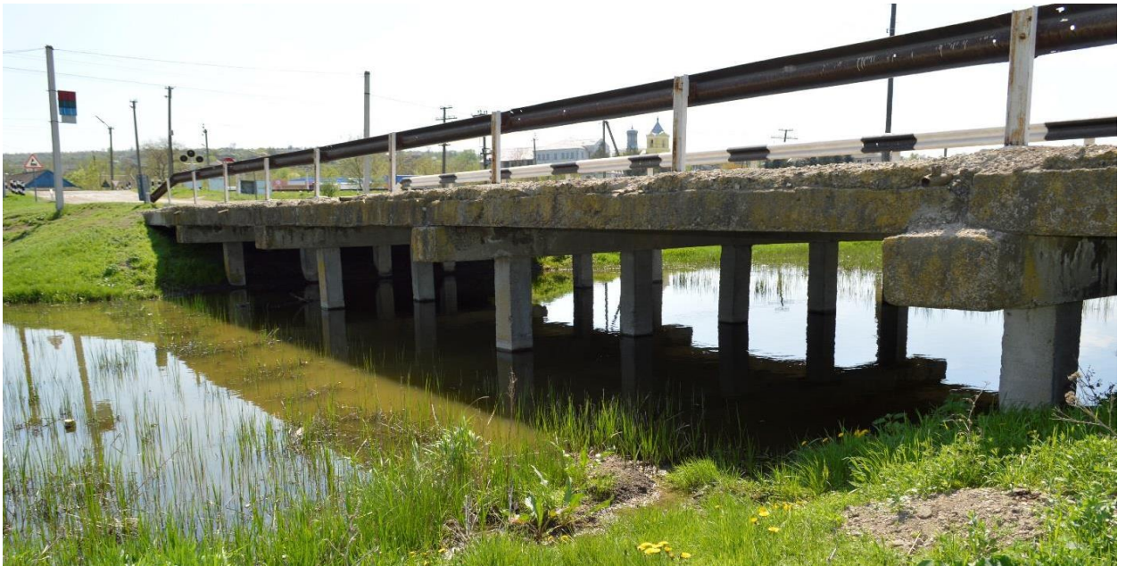
Km 15,400. Podul necesită reparație
