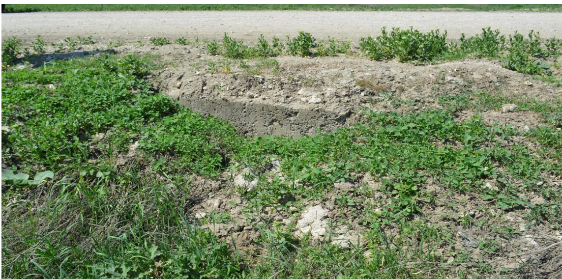
Figura 5.1.2. Podeț înămolit la km 14,800
